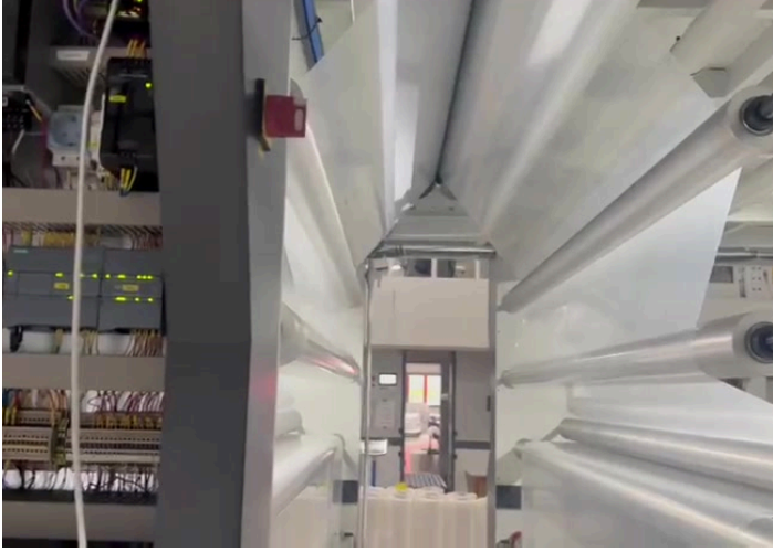
Film hattı ve elektrik panosu
